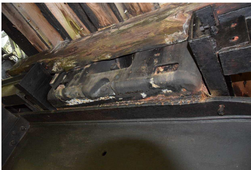
Il. 5. Uszkodzenia biologiczne elementów drewnianych i korozja stali, Bóbrka 2016
