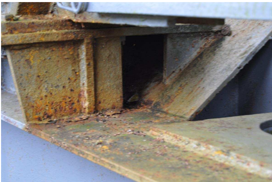
Il. 5. Odparzenia i odpryski farby spowodowane korozją stali przy górnym złączeniu konstrukcji wieży-masztu, Bóbrka 2016 r.
