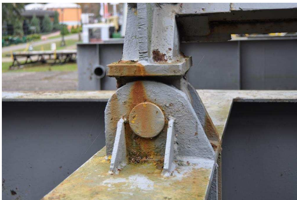
Il. 2. Korozja stali elementów węzła w konstrukcji wieżo-masztu, Bóbrka 2016 r.
