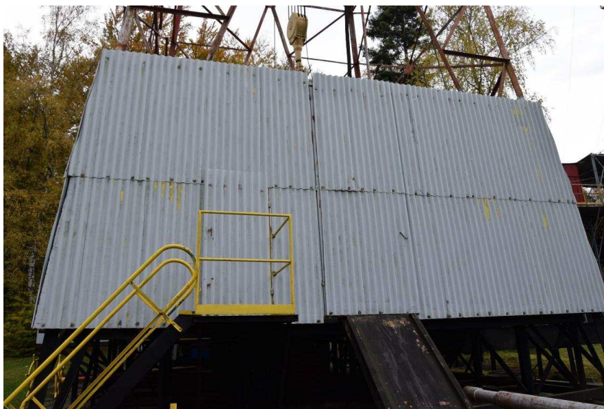
Il. 2. Osłona z blachy falistej urządzenia wiertniczego, widoczne odpryski farby spowodowane korozją metalu, Bóbrka 2016
