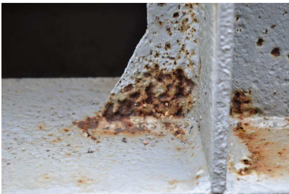
Il. 3. Korozja stali przy spawach łączących elementy konstrukcji wieży-masztu, Bóbrka 2016 r.
