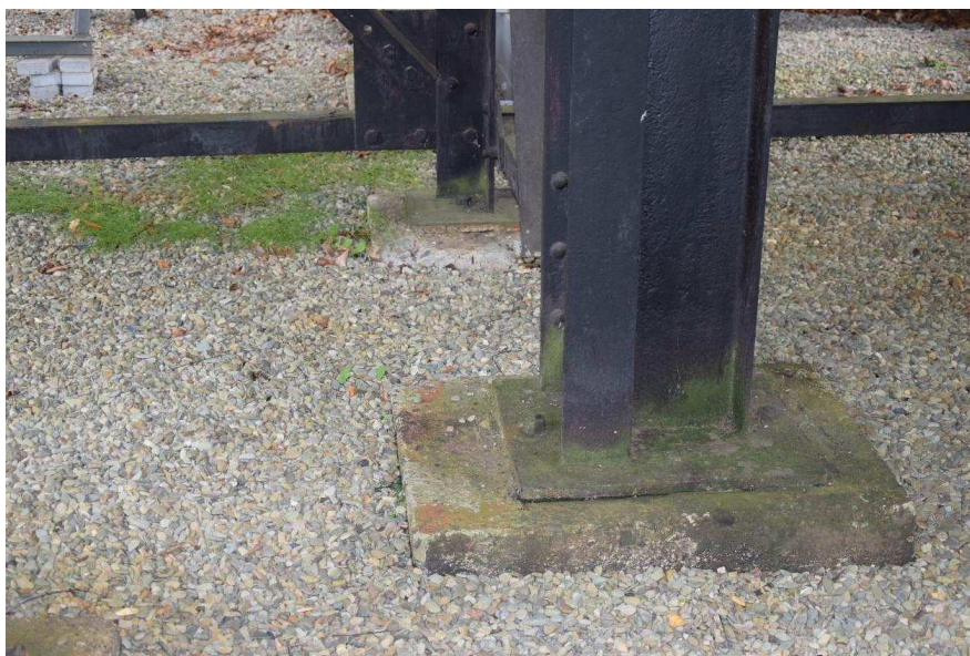
Il. 6. Korozja stali wieży nośnej wiertnicy, Bóbrka 2016
