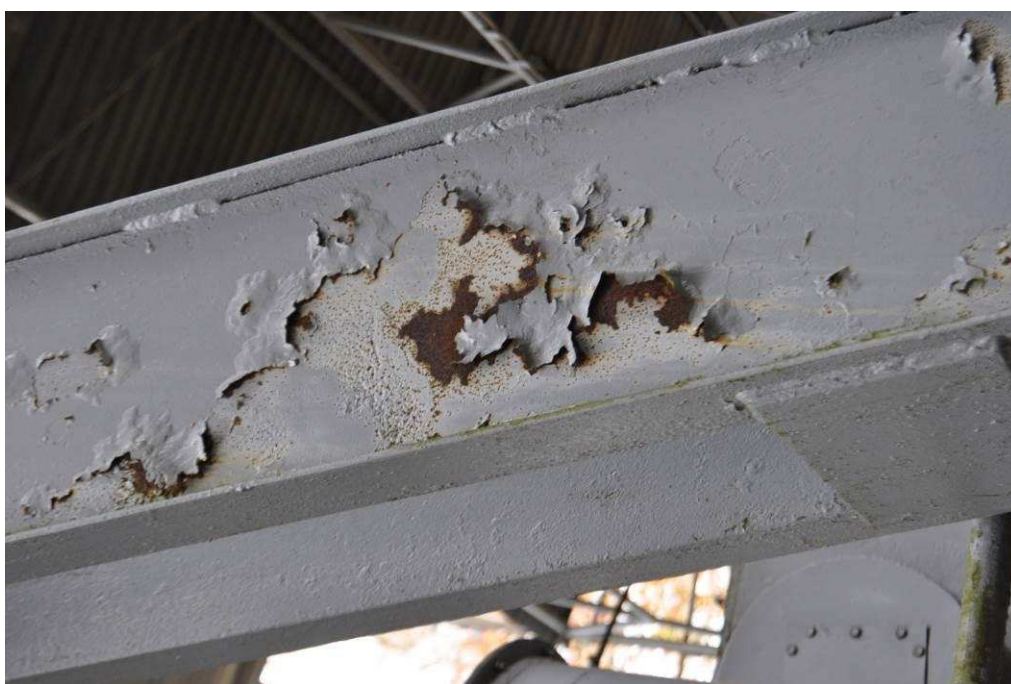
Il. 4. Odparzenia i odpryski farby spowodowane korozją stali na elementach konstrukcyjnych wieży-masztu, Bóbrka 2016 r.
